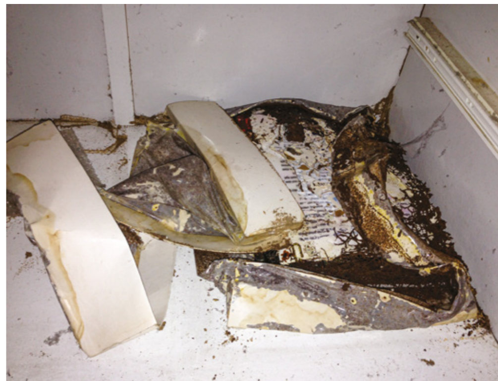
FIG. 24. Material atacado por térmitas, chamado cupim de solo subterrâneo, em um acervo pessoal.
